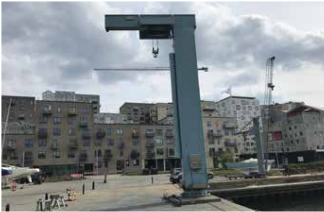
Arbejdsområde under mastekranen. Manglende stiforløb
